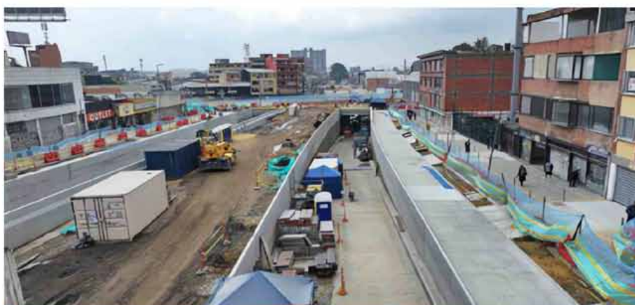
Así como avanzamos en varios componentes del proyecto, hay otros donde debemos mejorar. Un ejemplo es el intercambiador vial de la Calle 72, donde el concesionario no ha cumplido los tiempos de entrega y ha tenido que comprar 60 días adicionales para entregar la obra.
