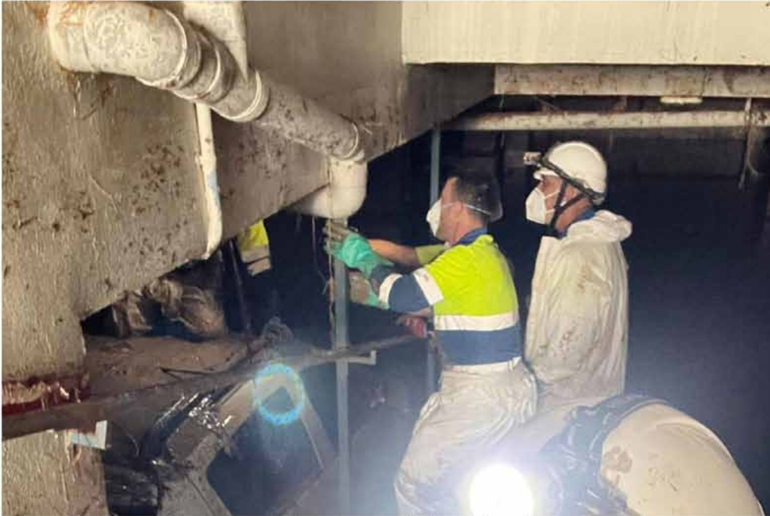
Salvador Palma sujetando una tubería en un garaje inundado - Al
