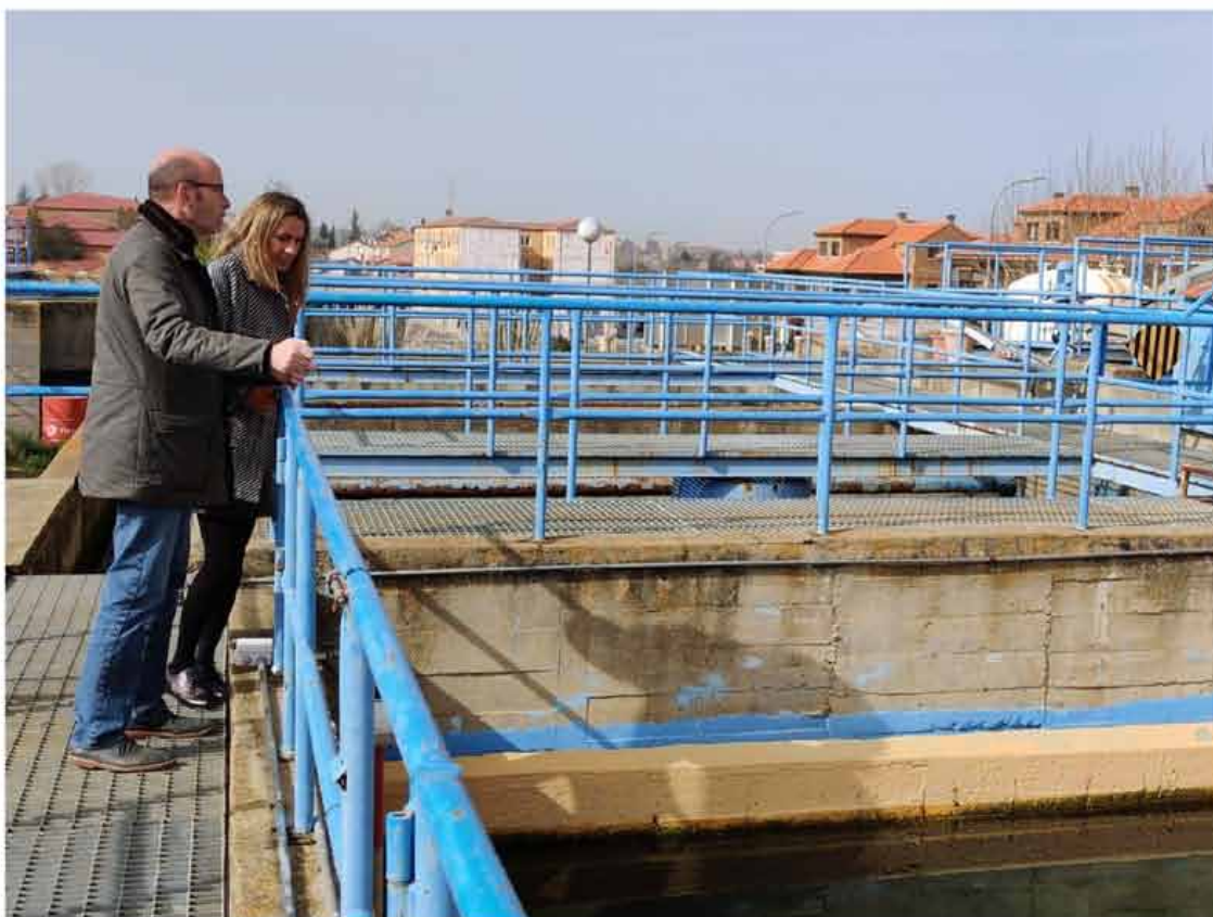
Estación de agua potable de Santa Marta
